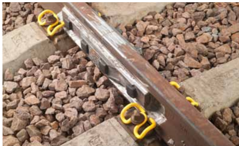
MT-Stoß verstärkt an Vignolschiene MT-joint reinforced on flat bottom rail MT-joint renforcé au rail vignole
